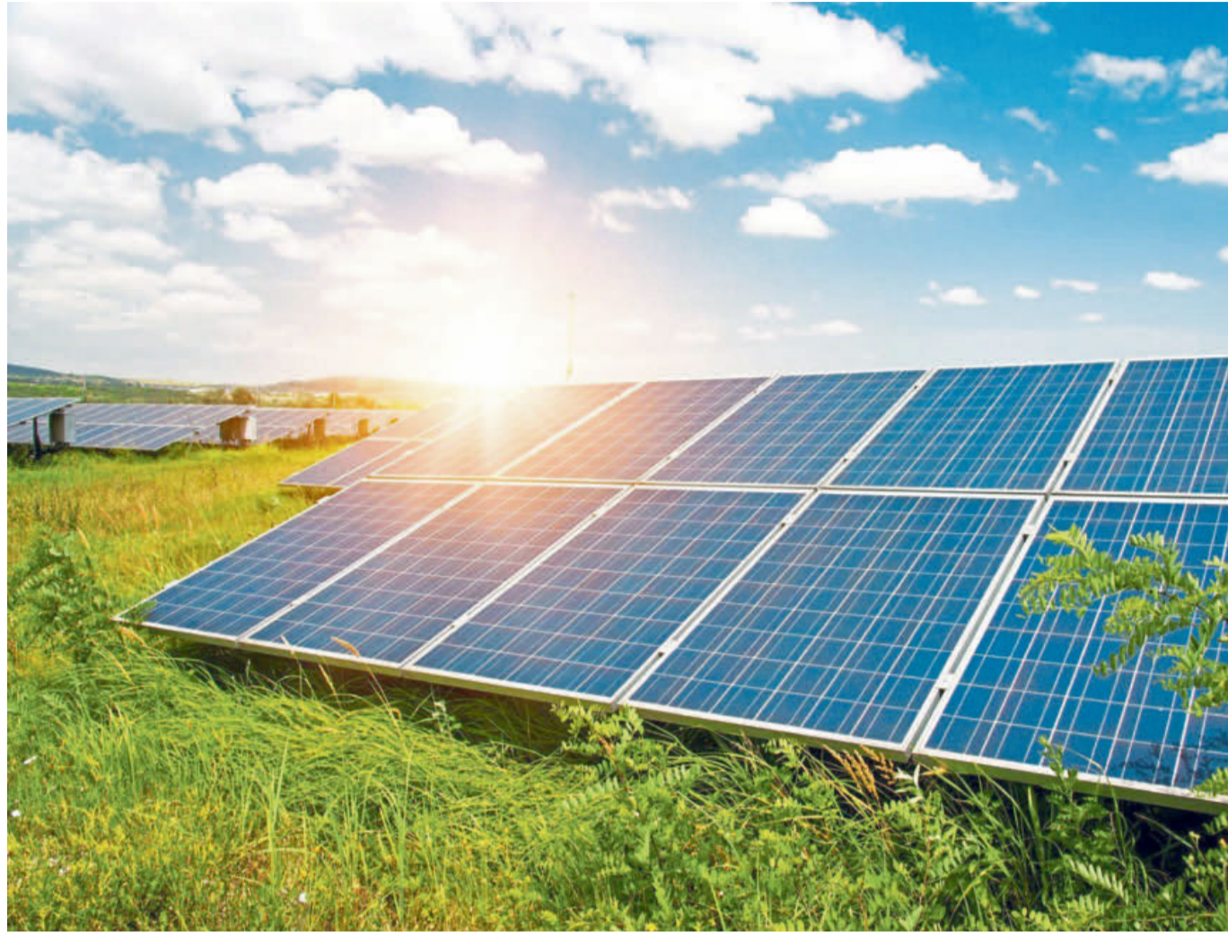
Photovoltaik (hier ein Symbolbild) lässt sich nicht nur auf dem Dach, sondern auch auf der freien Fläche installieren. Eine Berliner Firma plant einen Solarpark in Form einer Freiflächen-Photovoltaikanlage in Holsen.
